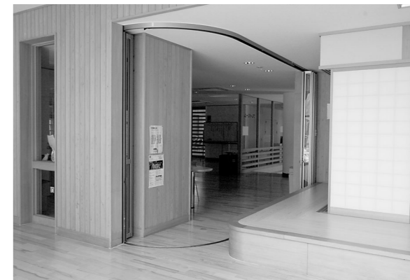
・取り付けられたスライディング・シャッター 工事中の対応で設置したシャッター。普段は開放されています。
