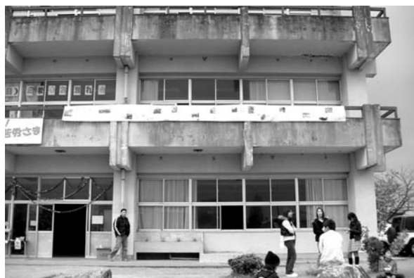
かぶり厚のモルタルが剥離するなど、劣化が進んでいました(石本建築事務所提供)
